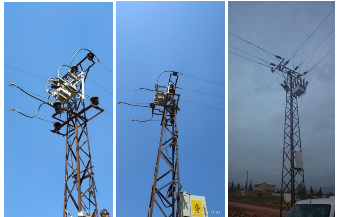
Resim-8: Recloser tesis örnekleri
