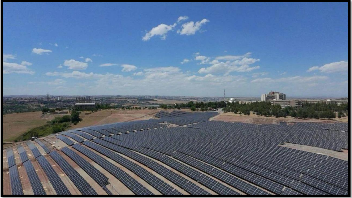
Dicle Üniversitesi Güneş Enerjisi Santrali
